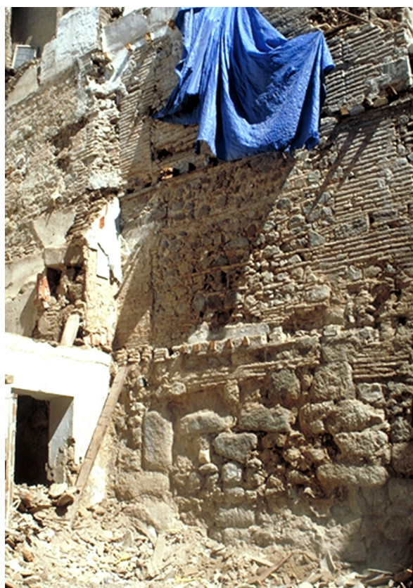
Fig. 2. Mur ancien de gros appareil, mis à jour en 2001, à l'arrière de la maison n° 6 de la calle de San Ginés.
